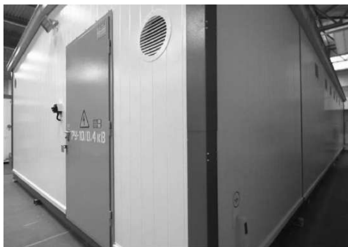
Рис. 1. Общий вид комплектной трансформаторной подстанции проекта «Арктик СПГ 2» с функциями цифровой подстанции
