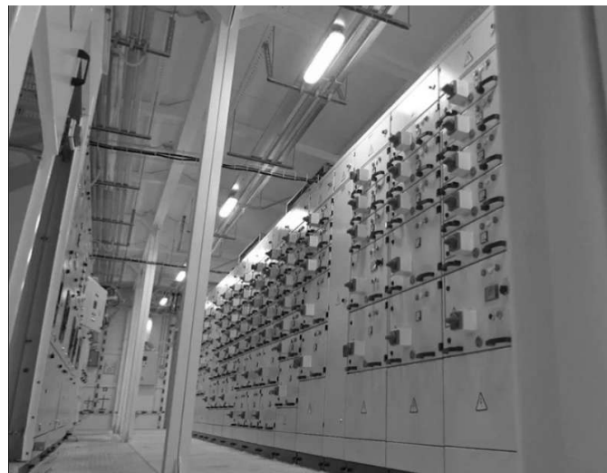
Рис. 2. Комплектное распределительное устройство РУНН «Каскад» цифровой подстанции
